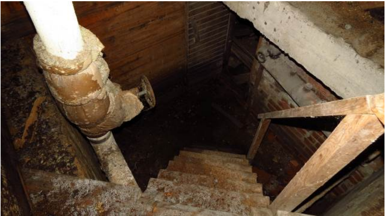
Kuva 7. Vanhan kuivaamon pohjoispään itäreunalla sijaitseva kellarisisäänkäynti, jonka rakenteet ovat ehtineet hyvin heikkoon kuntoon.
