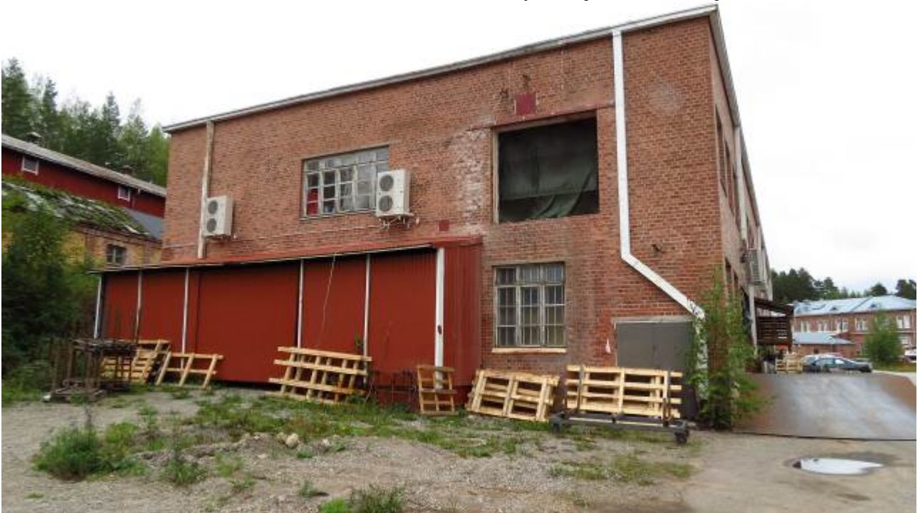
Kuva 9. Tikkutehtaantie 4:n rakennuksen eteläpäädyn tuotantotiloihin puhkaistu nostolavareikä. Kuvasta näkyy myös katon ja tiiliverhouksen yhtymäkohdan tiivis, ullakotilan minimoiva rakenne.
